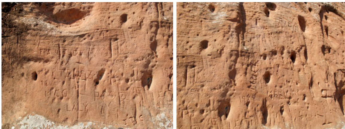
Fig. 11. Eremitorio de Valdecanales. Deterioro por actos vandálicos. Fotografías: María Higuera Muñoz.
