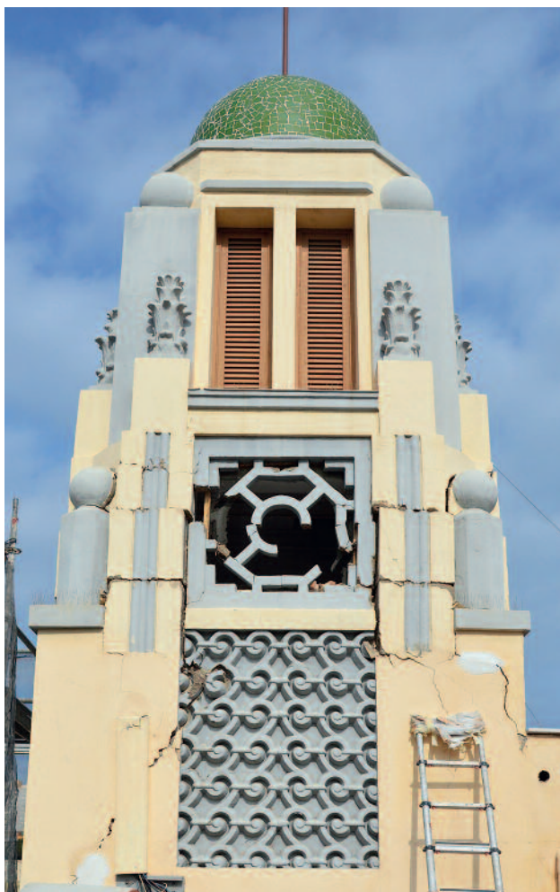
(Figura 2) Rotura y desplazamiento de pilastras en los torreones.
