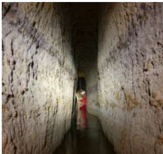
Figura 6. Galería inundada de la mina de agua Oromana.
