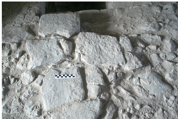
Fig. 68: Planta Tercera. Pavimento original de la sala (s. XIII), con empedrado dispuesto sobre el migajón de la torre, que incorpora varias losas de piedra en el desembarco de la escalera primitiva.
