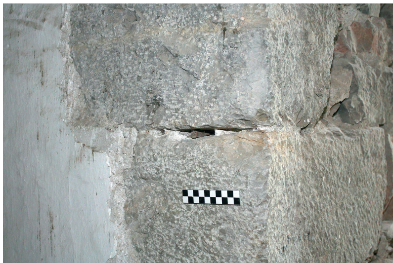
Fig. 41: Planta Segunda. Detalle de la esquina interior de la puerta original de entrada, con cuña de madera in situ.
