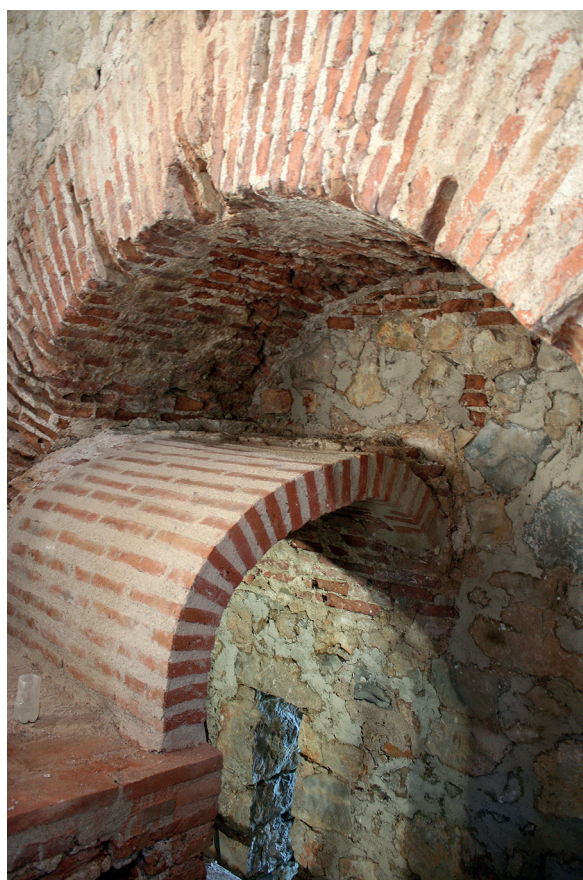
Fig. 65: Arco de descarga (U.E. 229) en el paso original (s. XIII) que comunicaba las plantas Segunda y Tercera, con bovedita U.E. 104 (parcialmente reconstruida) y aspillera.
