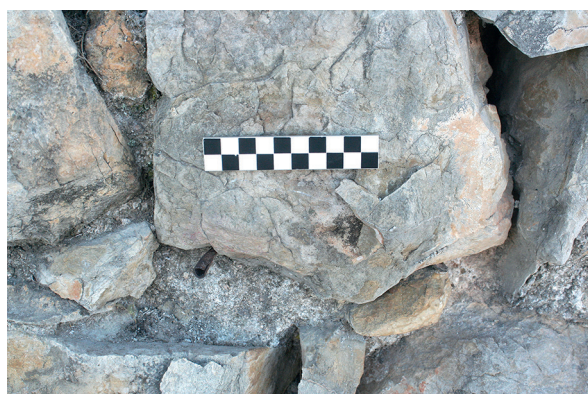
Fig. 45: Fachada 4. Punta nº 1 en su posición de impacto, con fractura de la arista del mampuesto inmediato.
