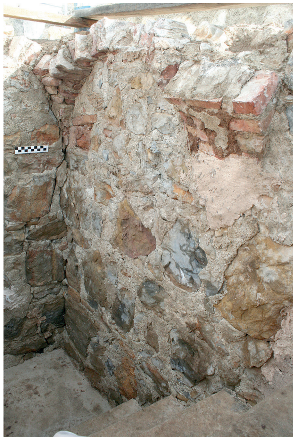
Fig. 66: Paso original (s. XIII) entre la Planta Tercera y el terrado, con estructuras muy dañadas por la apertura de la caja de escalera del siglo XVI y las reformas posteriores de la misma. Se pueden reconocer los arranques de una bóveda de arista (U.E. 224) y un arco de medio punto (U.E. 225), ambos en ladrillo.
