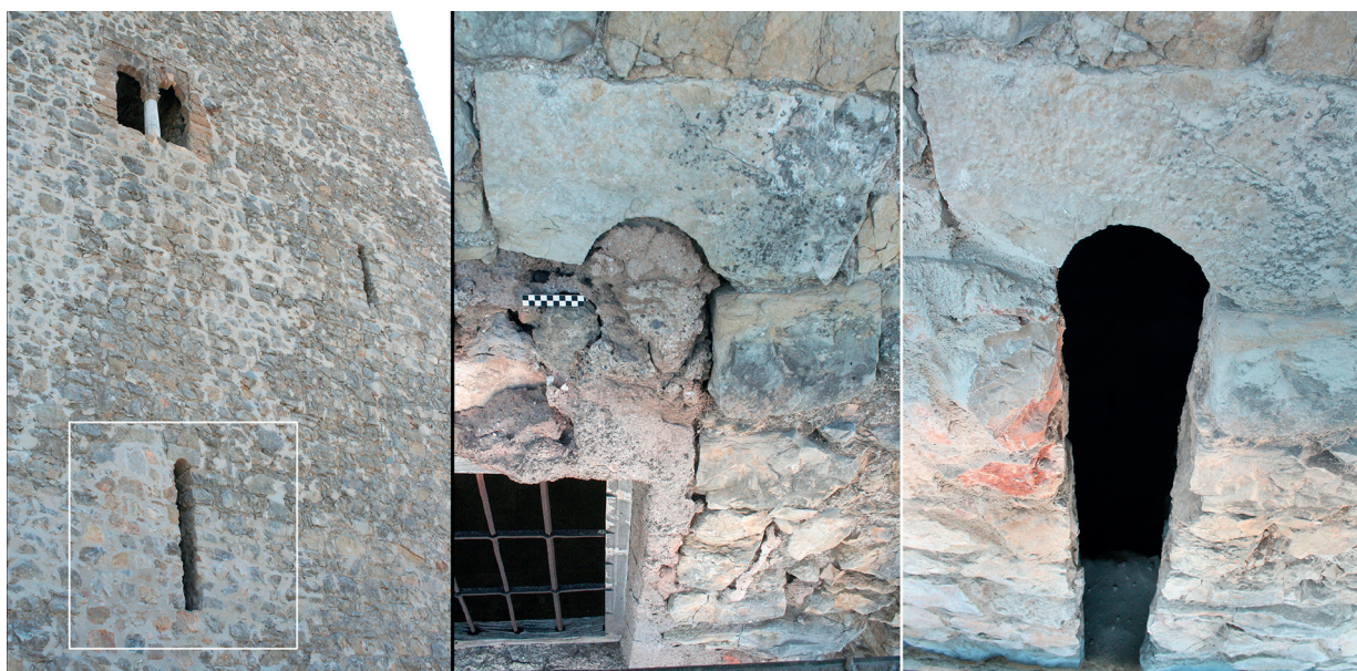
Fig. 76: Planta Segunda. Aspillera de la Fachada 4 (exterior). Estado anterior y posterior a la intervención.
