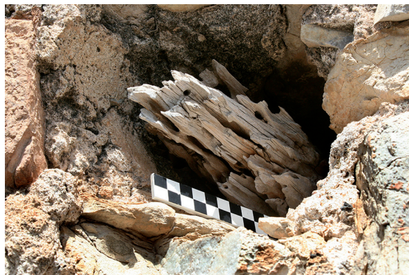
Fig. 38: Mechinal d del ajimez de la Fachada 2 (Tipo 1), con restos de madera original del siglo XIII, datada por C14.
