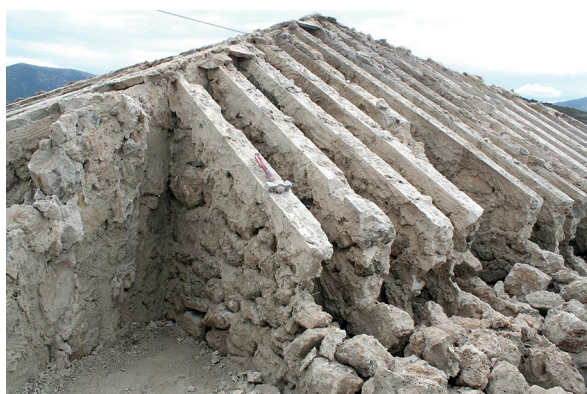
Fig. 11: Terrado. La cubierta en proceso de desmantelamiento, con empalomado que soportaba cuatro faldones.
