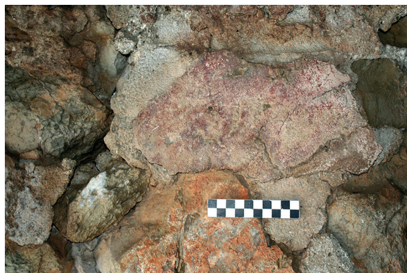
Fig. 56: Planta Tercera. Ajimez 4, cámara. Restos de enlucido de mortero de cal con pigmentación roja (U.E. 267).
