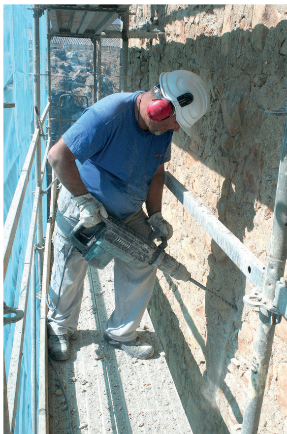
Fig. 7: Los cosidos estructurales de la torre han sido las acciones que han requerido una mayor inversión de tiempo y presupuesto del proyecto de consolidación.
