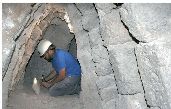
Fig. 9: Terrado. Galería transitable bajo la cubierta de teja, con cuatro tramos paralelos a cada una de las fachadas, antes de su dismantelamiento.
