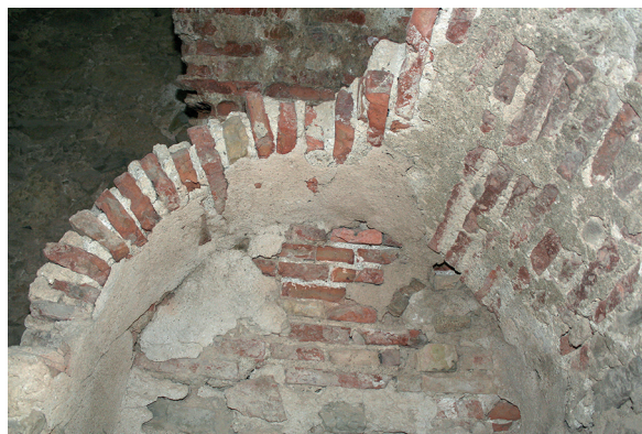
Fig. 64: Paso original (s. XIII) entre las plantas Segunda y Tercera, antes de la intervención. Bóveda U.E. 103. Los enlucidos de yeso no corresponden a la fase fundacional.
