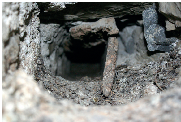
Fig. 55: Planta Tercera. Ajimez 2. Restos de madera pertenecientes a la caja o mortaja del alamud.
