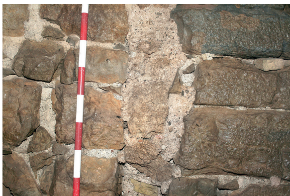
Fig. 69: Planta Tercera. Amortización con mampuestos y mortero de yeso (U.E. 266) de la mortaja del bajante que conducía las aguas pluviales al aljibe de la planta inferior de la torre.
