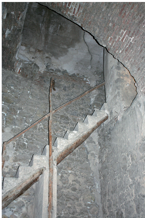
Fig. 24: Planta Tercera. Escalera de comunicación entre la Planta Segunda y el terrado, desmantelada al inicio de los trabajos de consolidación.
