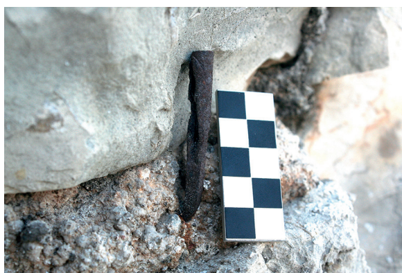
Fig. 46: Fachada 3. Punta nº 2 en su posición de impacto, con deformación significativa.
