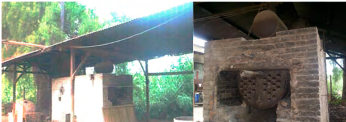
Caldera tubular a vapor con chimenea metálica. Fuente: Archivo personal.
