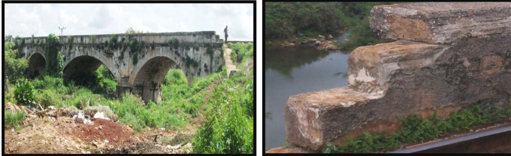
Estado actual en que se encuentra la obra, mostrándose sus principales deterioros. Fuente: de los autores.
