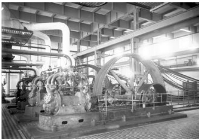
Figura 4 – Sala das máquinas no Frigorífico Anglo.
