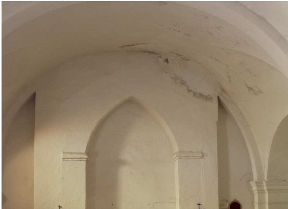
Fig. 22: Marcas de restos de cubierta a dos aguas y artesanado de la fase mudéjar.
