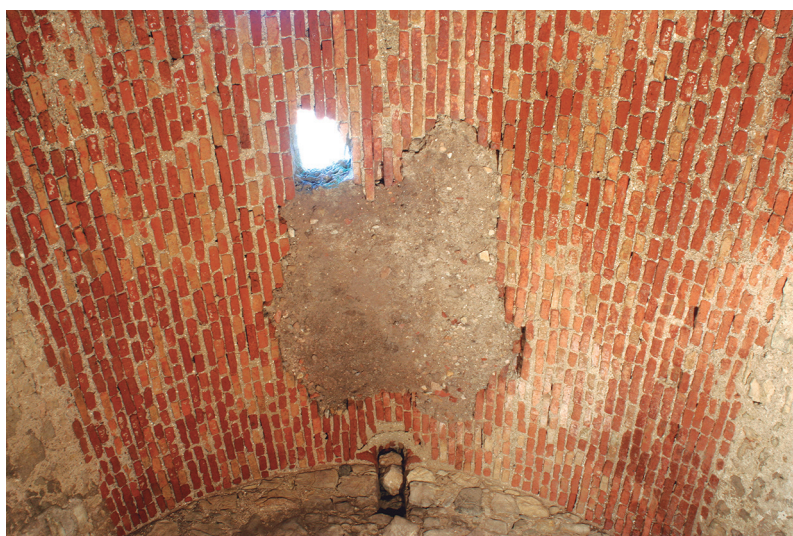
Lám. 12. Rotura en la bóveda del aljibe (Rotura nº 6) situada en el mismo lugar donde se dispuso en la Edad Media un pozo para la captación del agua almacenada.
