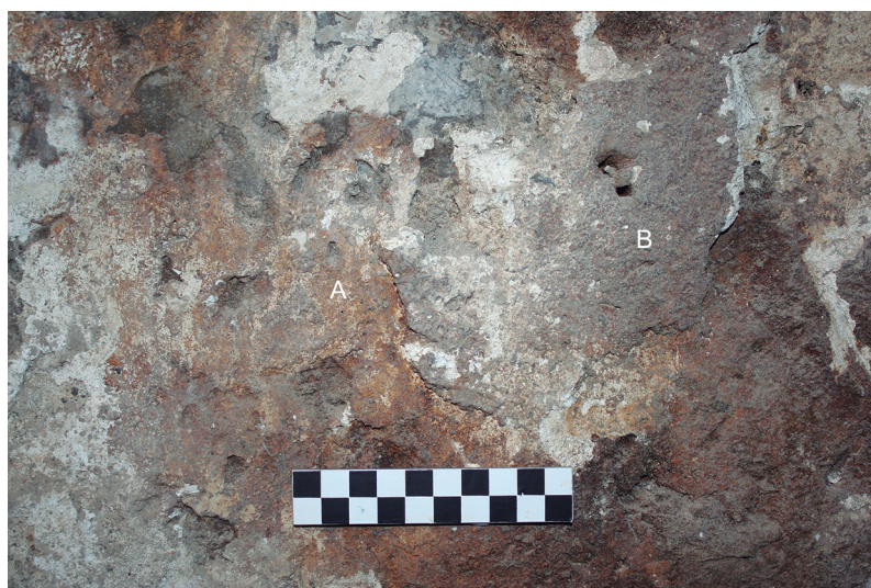
Lám. 5: Aljibe. Llagueado original de la mampostería medieval interior, con mortero de cal (A), y superposición de enlucido postmedieval de yeso (B).
