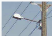
Luminaria existente que no admite nuevas lámparas y equipos
