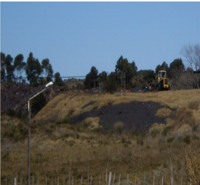
Figura 3 Relleno de RAF colmatado
