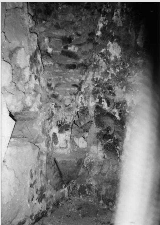
ÁNGULO REVENTADO DE LA ANTIGUA BÓVEDA DE LA CAPILLA DEL HOSPITAL. FOTO JESÚS A. GLEZ. CALLE
