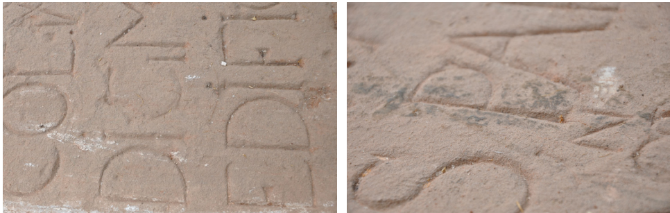
Figs. 8 y 9: Detalle de manchas de cal sobre la superficie epigráfica (izq.) y detalle de suciedad y abrasión por un mal manejo de la obra (der.). Fotos: PAEJ, 2012.
