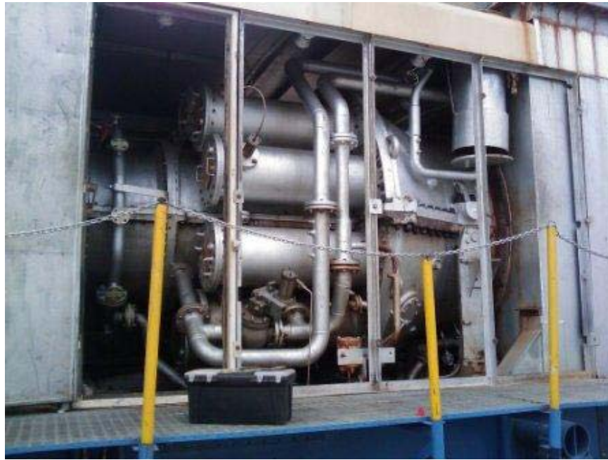
Figura 4: Turbina General Electric MS5001P en Campo.
