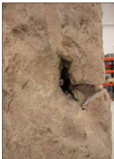
Foto 37: Detalle del rebaje alrededor de la perforación natural de la losa en cara posterior.
