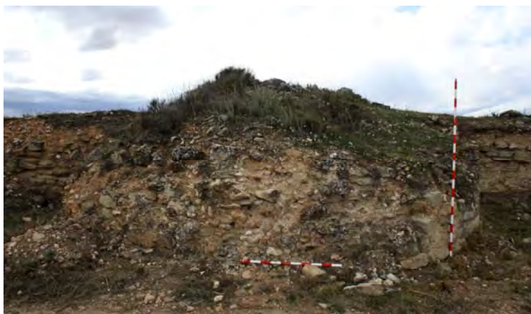
Lámina 68. Pérdida de la cara exterior quedando el alma vista. Cubo 3.
