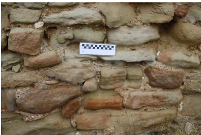
Lámina 72. Lavado y erosión de fábricas. Detalle.
