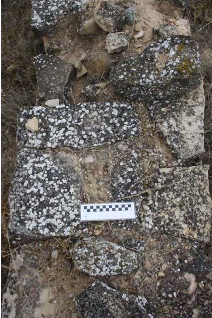
Lámina 74. Líquenes y hongos en muros de compartimentación de las estancias del norte.
