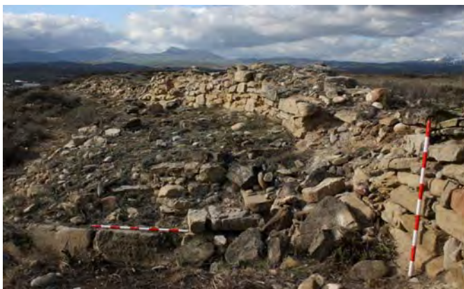
Lámina 73. Desplazamiento y derrumbe de paramentos de la muralla. Lienzo J.
