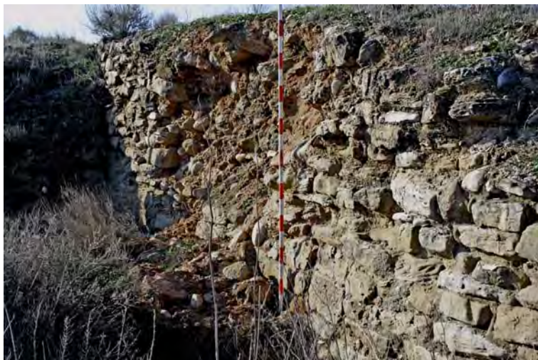
Lámina 67. Desprendimientos recientes en colada. Lienzo D.
