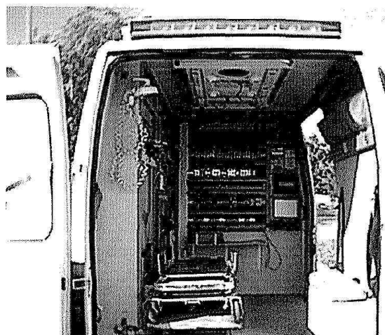
Figura 9.—Cuadro de eléctrico de conexiones, medida y control ubicado en la parte trasera del vehículo.
