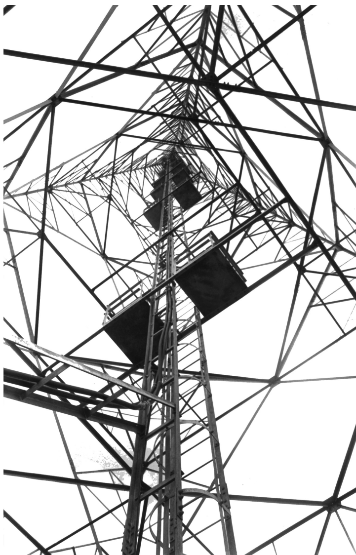
Torres de alta tensión. Foto: El Tiempo.
