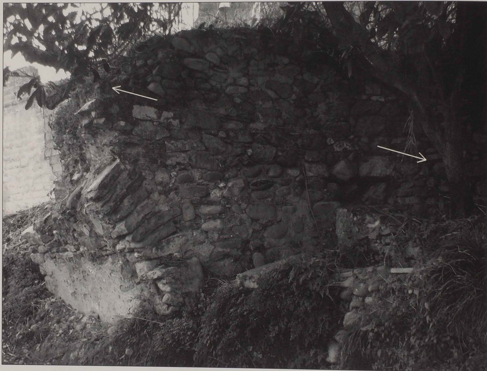
Desnivel de la rampa de acceso y salida al puente, sobre el arranque derecho.
