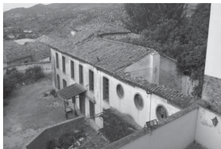
Molino de los Montoro. El derrumbe de parte de la cubierta se ha producido en 2010
