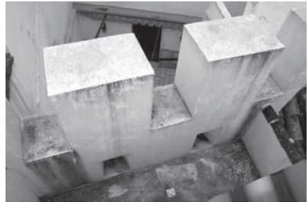
C/. Álvarez, 1. Reconstrucción parcial de parapeto y merlatura de la muralla medieval
