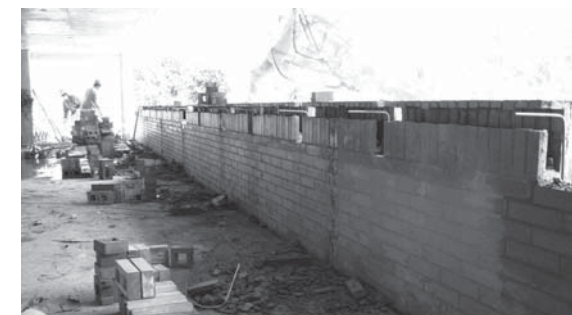
Arq. Javier vera – Edificio Mario Laserna, Universidad de los Andes. Fachada en ladrillo anclada y reforzada internamente contra sismo. Las columnas internas, que se ven insinuadas por las líneas más húmedas en la foto, se amarran con una vigueta de confinamiento inserta dentro de la hilada de remate del antepecho. Foto: María Luisa Vela.
