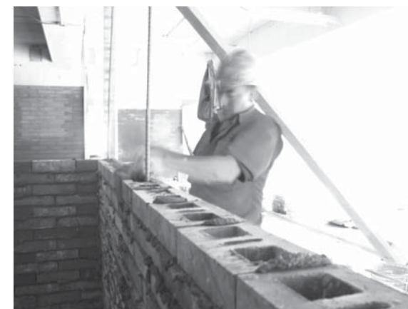
Arq. Javier Vera – Edificio Mario Laserna, Universidad de los Andes. Fachada en ladrillo anclada y reforzada internamente contra sismos. Gracias a las celdas de los ladrillos, es posible incluir un acero de refuerzo y posteriormente rellenarla con concreto fluido, formando una columna interna. Foto: María Luisa Vela.
