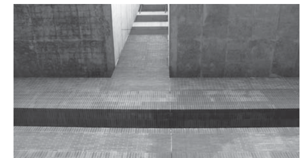
Arq. Javier Vera – Edificio Mario Laserna, Universidad de los Andes. La aparición de grandes elementos horizontales, rígidos, como antepechos, demanda el uso de juntas de control que absorban los movimientos transmitidos por el entrepiso a la fachada y los movimientos derivados del cambio de temperatura y contenido de humedad. Foto: María Luisa Vela.
