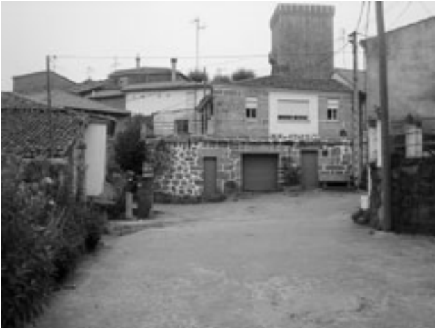
Dúas vistas da Rúa da Igrexa, antes e durante os traballos para saneamento, abastecemento e colocación do novo pavimento
