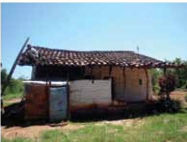
5. Vista del caney antes de su recuperación en la zona de las habitaciones y el baño en bloque de ladrillo.
