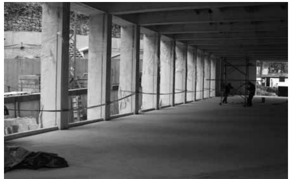
27. Detalle del concreto utilizado para el proyecto. Se ve el hueco generado por los form-clamps que sostienen las formaleas durante el proceso de fundición.
