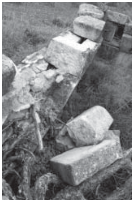
Huerta del Letrado. Daños producidos en la alberca monumental
