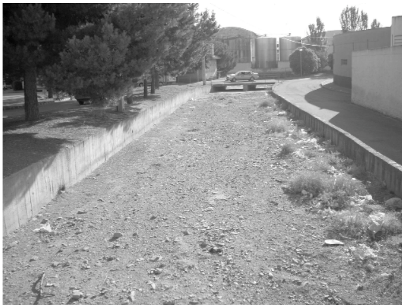
Figura 2. Barranco Cuatro Esquinas (Cariñena, Zaragoza). Foto: S. Doménech.
