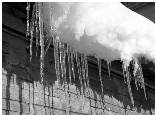
Las heladas forman estalactitas de hielo o chapiteles , en los aleros de los tejados
