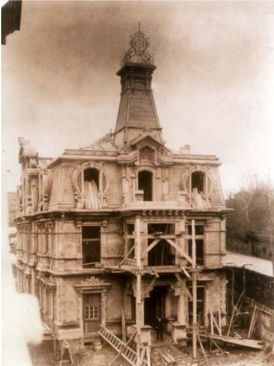
La «casa de doña Águeda» en plena construcción alrededor de 1914. En la puerta, D. Eduardo González García. Gentileza de D. Jaime Lafora.
