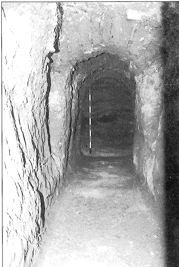
Fotografía 10. Interior horno nº 5.
