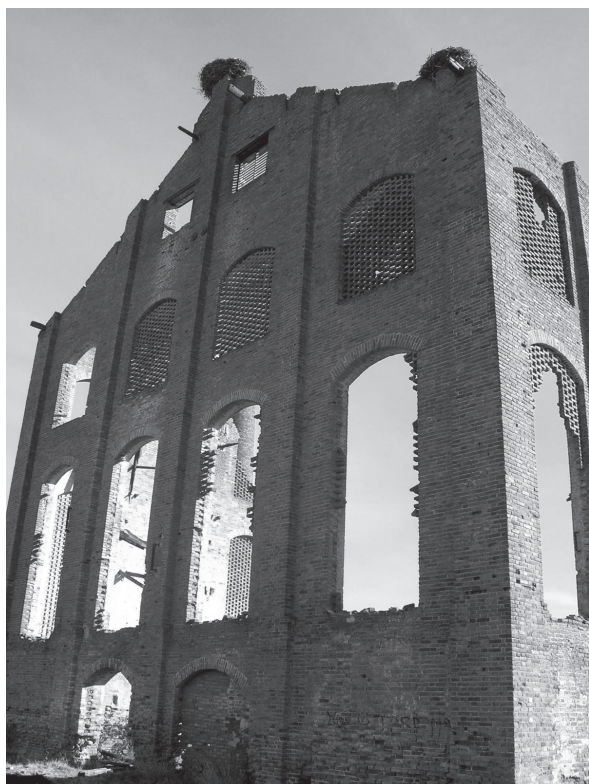
Lám.1: Un edificio del Cerco Industrial de Peñarroya-Pueblonuevo (Córdoba), claro ejemplo de destrucción post-abandono (autor).
