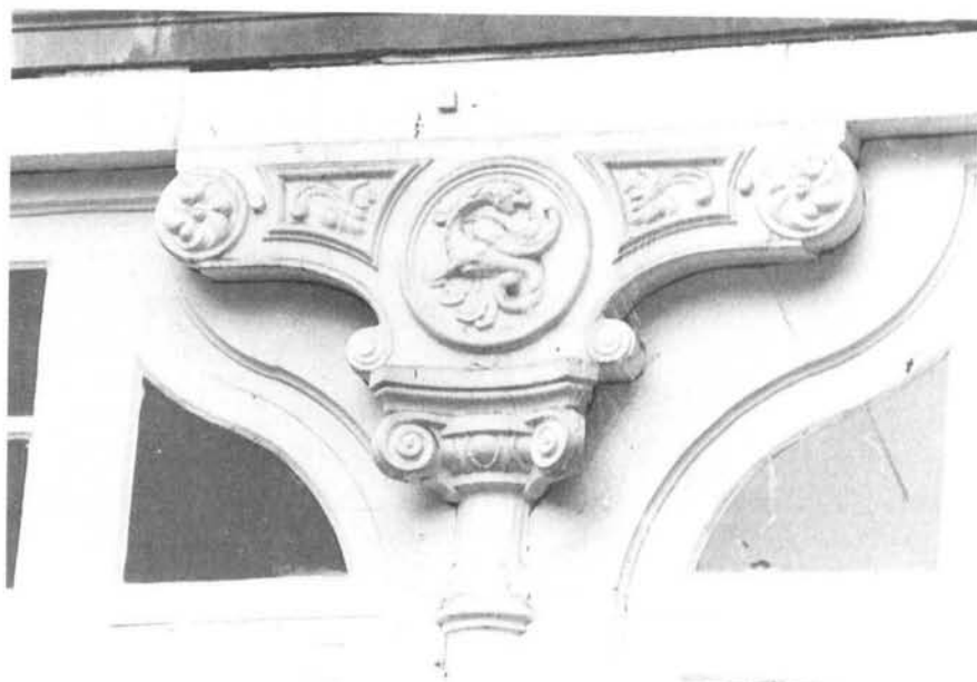
Detalle de capitel y zapata de uno de los soportes de la galería de la planta baja.
