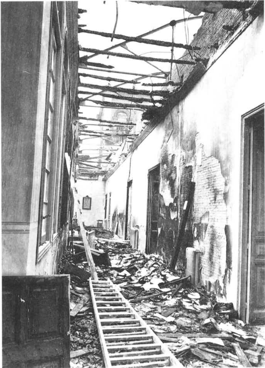
Galería superior después del incendio.
