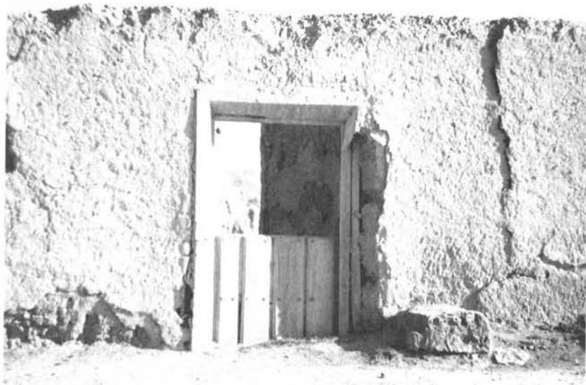
FOTO 1: Casa en ruinas en Castromocho
