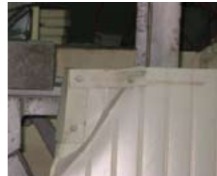
Figura 14c. Estado del panel luego del ensayo experimental
