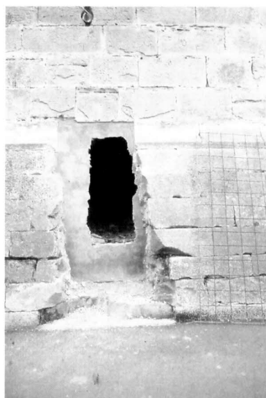
Foto 9. — Forat obert en el talús del mur nord-occidental (Servei d'Audio-visuals de l'IEI).
