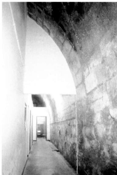
Foto 5. — Passadís resultant de la compartimentació del sector occidental de la galeria sud (Servei d'Audio-visuals de l'IEI).
