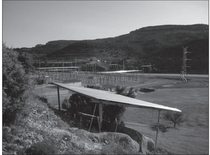
2. Vista general del conjunt de Fraiximeno (Morella), amb la Subestació de la zona 1, 2 i 3 del Pla Eòlic Valencià, a uns 150 metres del conjunt. Actualment es troba protegit per una coberta provisional.
