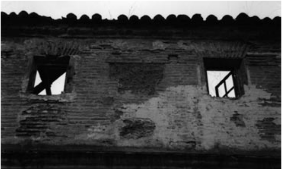
Lienzo de muro en el que se aprecian materiales y aparejo (foto R. Marín).
