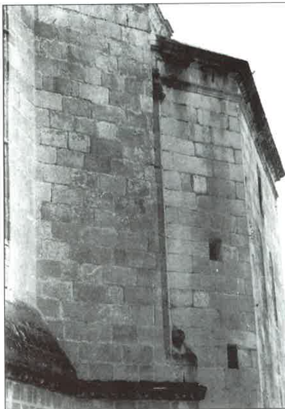
Fig. 26: Contrafuerte exterior de la capilla de San Juan y su unión a la capilla de las Nieves de la Catedral de Orense.
