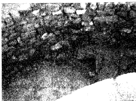
FOTO 8: La cerca exterior presenta por su paramento interior patologías propias de la acción mecánica.
