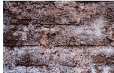
Foto 3- Eflorescencias y criptoflorescencias salinas en ladrillo y mortero de la iglesia parroquial de San Miguel Arcángel de Alfaro (La Rioja). Las sales rebosan de las juntas..
