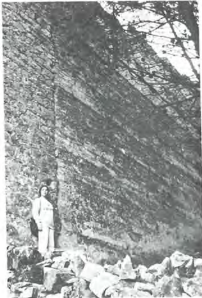
Muralla almorávide de Jaén. La foto corresponde a un sector extramuros del segmento que baja a la puerta de la Llana. La solución de continuidad en mampostería corresponde a una reparación de época cristiana, en la que son datables también sucesivos recrecimientos observables intramuros. (Juan Eslava Galán, 1984).
