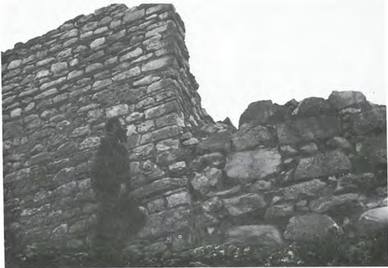
Detalle del parapeto exterior del castillo Abrehuí, uno de los tres recintos que confirmaban los alcázares de Jaén. El muro, mucho más tosco, de la derecha corresponde a una pequeña albacara ciega que se le añadió tardíamente. (Juan Eslava Galán, 1984).
