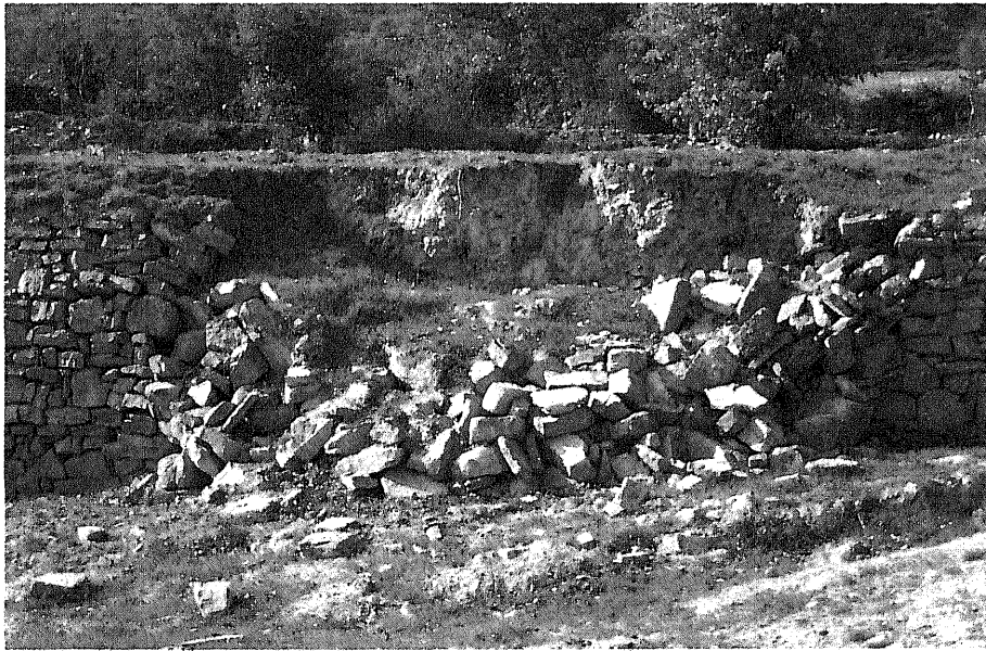
Desprendimiento en Dehesillas. Octubre 94.
